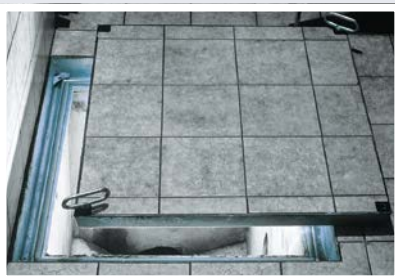
BV eingebaut in Putzschacht
